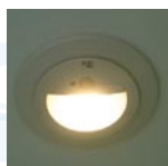
⑤照明設備
